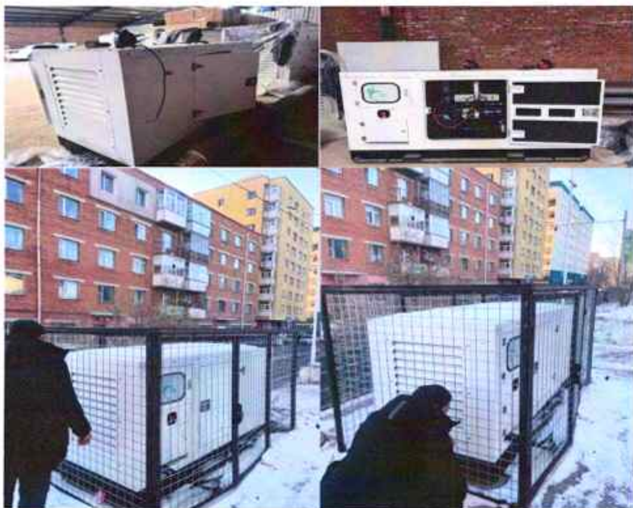
Зураг 7 Дизель генератор суурилуулсан
