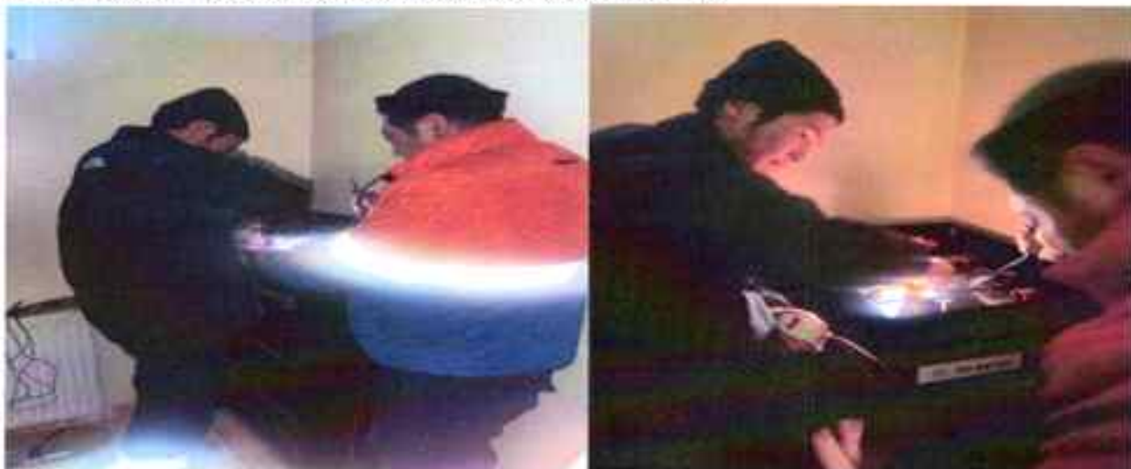
Зураг 6 APC's Smart-UPS RT төхөөрөмжийн суурилуулалт
